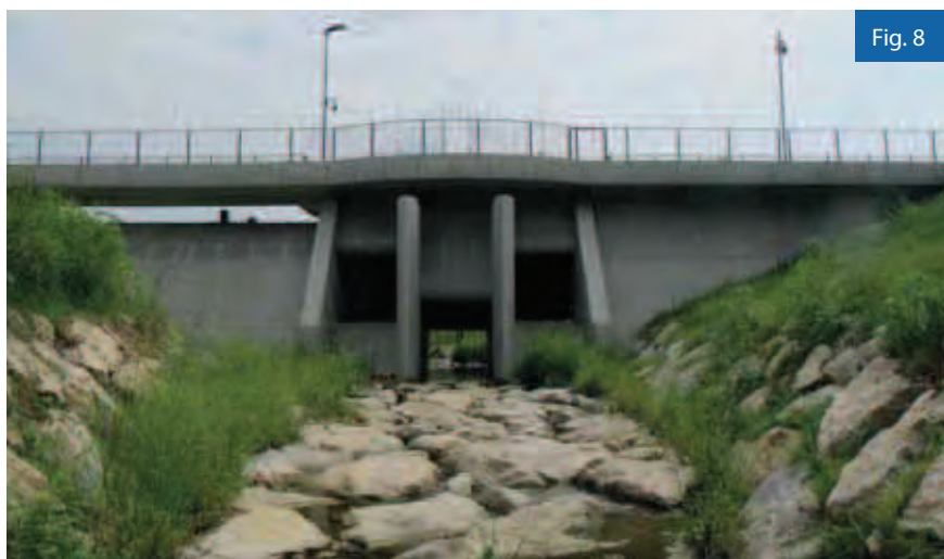
7 Vista d'insieme da sud-est della parte centrale della traversa dopo il primo rinverdimento dei terrapieni
